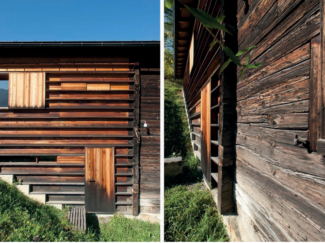
SOLDA Solda 1990'lı yıllarda Gugalun Evi'ne eklenen ahşap strüktür (Camus, 2013) ve sağda 1709 yılında inşa edilen Gugalun Evi'nin günümüze ulaşan ahşap strüktürü. (Camus, 2013) (Görsel 4).
