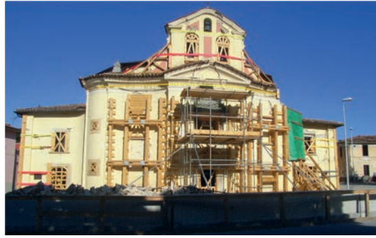
SOLDA L'Aquila (Görsel 13)
