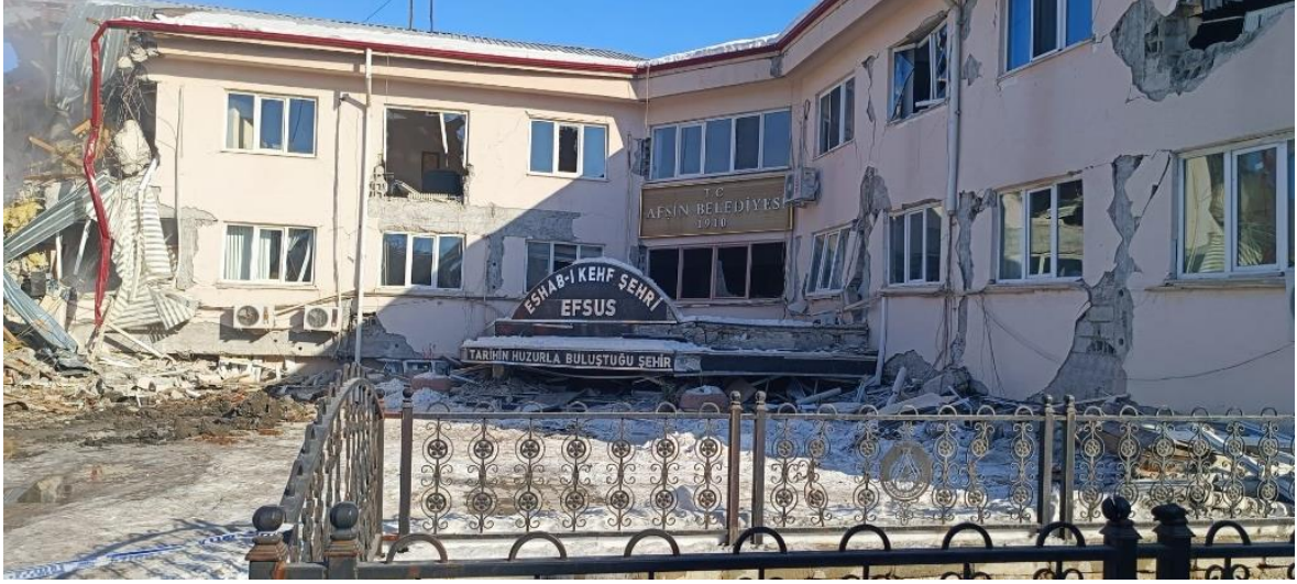
Fotoğraf: Afşin Belediye binası enkazı
