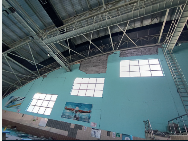
Şekil 3.52. Kalkan duvar hasarı
