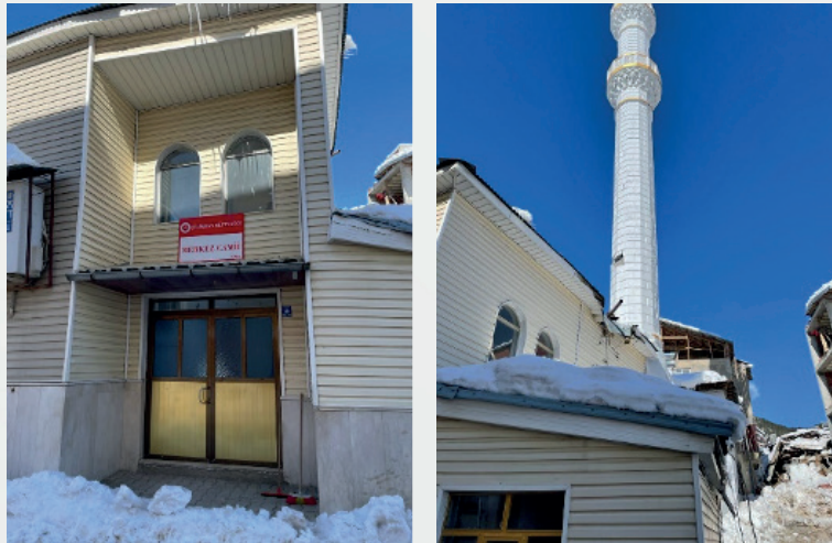
Şekil 3.62. Merkez Cami ve hasarlı minaresi
