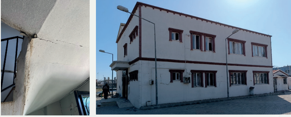
Şekil 3.51. Merdiven hasarı ve duvar hasarı
